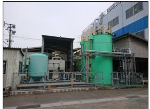
<写真は排水処理設備全景>
